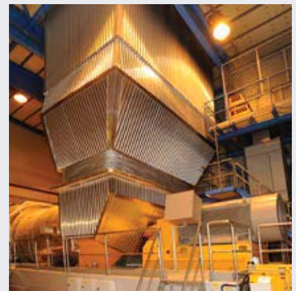
Uppsala Combined Heat and Power Plant, Vattenfall AB, Sweden.
