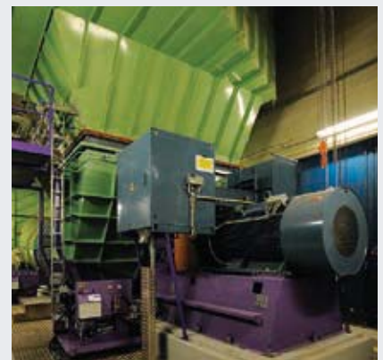
Uppsala Combined Heat and Power Plant, Vattenfall AB, Sweden.
